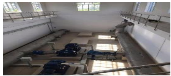
Trạm bơm cấp 2 Nhà máy nước Nam Rạch Giá
